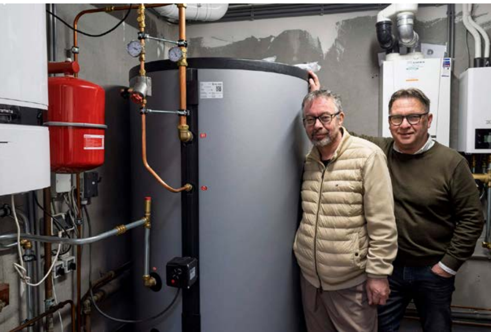
Gert Sanders (links) en Rinze Savenije bij een enorme nieuwe ketel in het kleedkamergebouw. © Foto: Boudewijn Bunting
